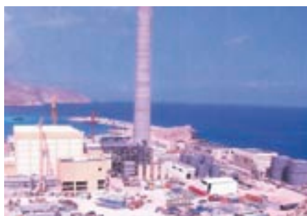
Elektřárna Atherinolakkos na pobřeží ostrova Kréta., kde jsou v současné době vznikají prostory pro novou technologii ŠKODA.
